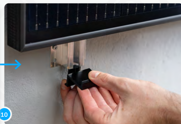
10 Ora sposta il pannello nella posizione desiderata e chiedi a qualcuno di aiutarti a fissare i morsetti.
