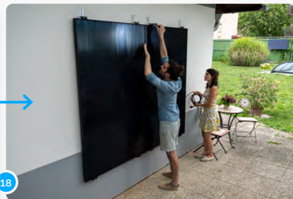
...controllare nuovamente tutti i morsetti accuratamente...
